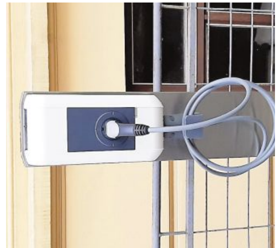
Wallbox zur Aufladung der eigenen E-Fahrzeuge.
