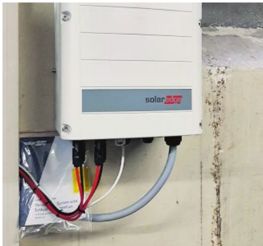
Durch den Wechselrichter wird der produzierte Gleichstrom in Wechselstrom umgewandelt.
