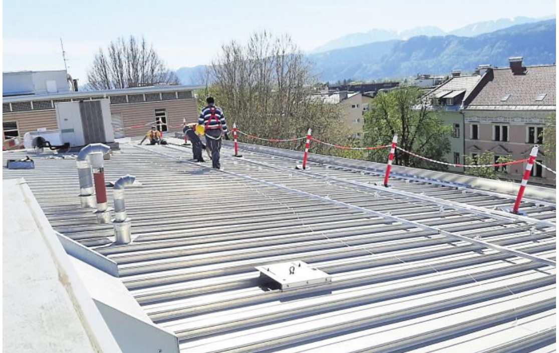
Blick über Klagenfurt bei der Montage des Unterbaus, auf entsprechende Sicherung der Monteure darf nicht vergessen werden.
